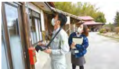
建物の地震被害を調査 (令和4年3月)
